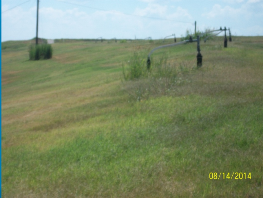
LANDFILL GAS WELLS
